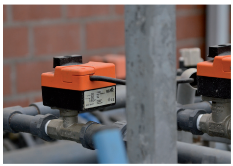
Alte Anlage mit einem Mischventil
