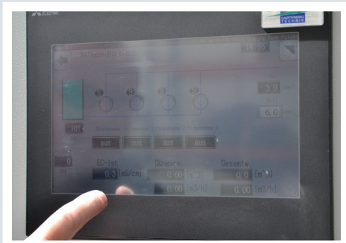
Neue Anlage mit Touchscreenlösung
