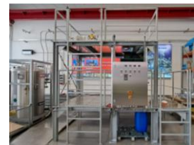
Kryogene Schälanlage mit Wirbelschneckenkühler. ©VT Research GmbH
